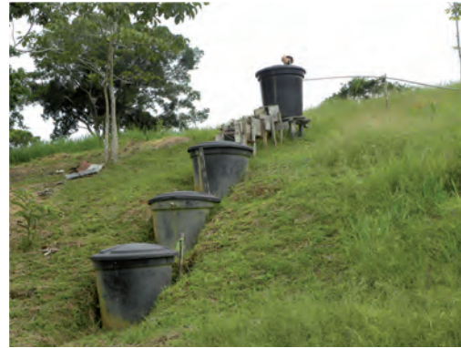
Det genialt enkla vattenreningsverket på plats.
